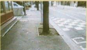
6 Ils ne sont pas assez marqués. Les barrières de protection gênent la circulation piétonne. Ces défauts créent des situations de handicap.
